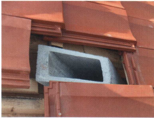
7 Der Schacht geht durch den Dachüberstand und endet mit einem Schrägschnitt zirka 2 - 3 cm oberhalb der Dachlattung.
